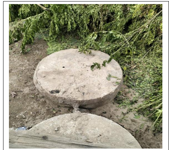
Bể Tự hoại nước thải sinh hoạt
